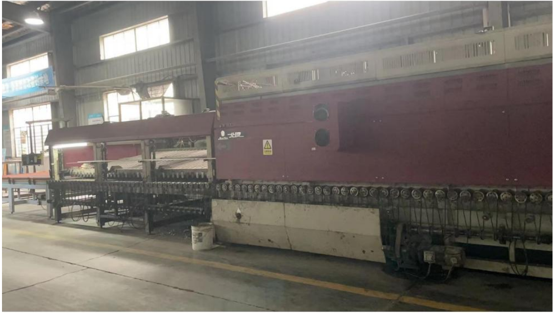
图 1 生产现场生产设备
